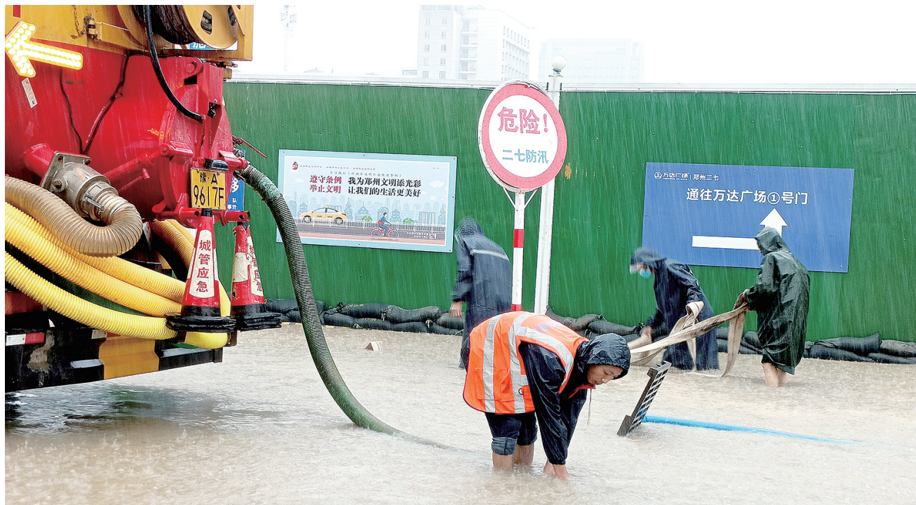
航海路与大学路交叉口出现积水,城管工作人员在紧张地进行排水作业
